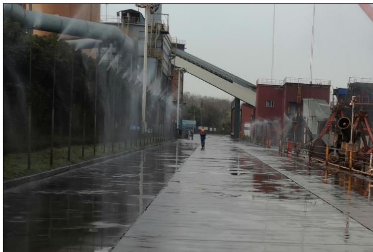
图 8.2-6 道路两侧喷雾桩现场照片
