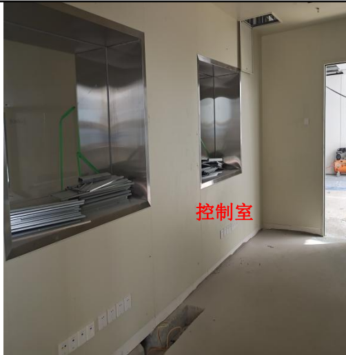
机房南侧控制室
