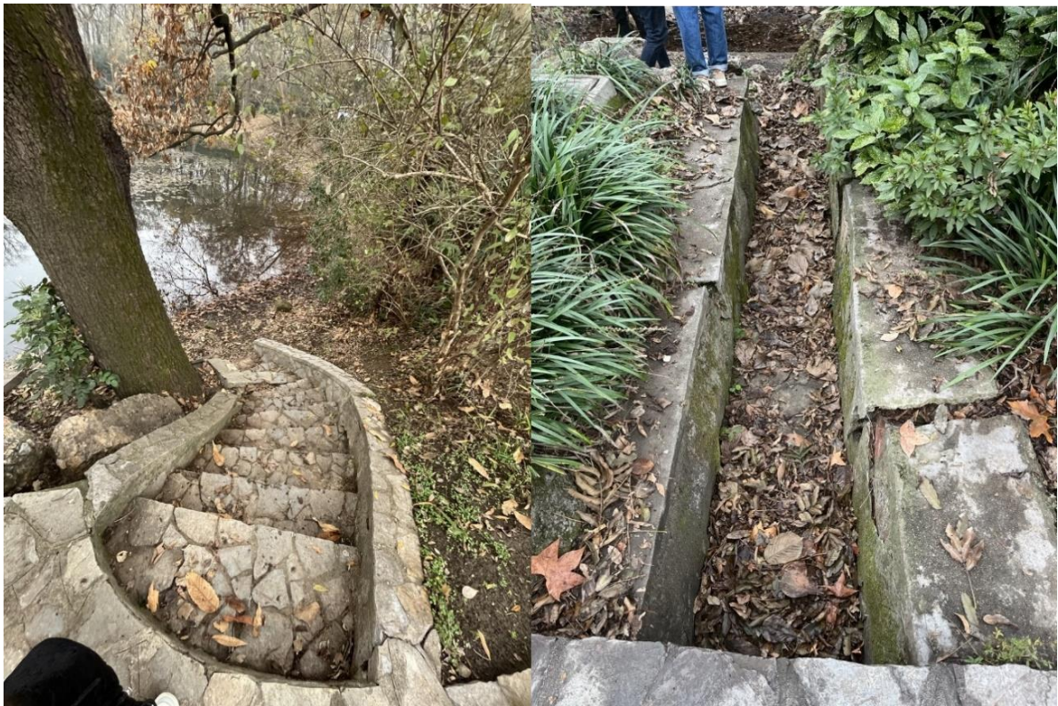
图 3.1-7 流徽湖构筑物破损现状照片
