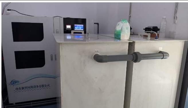
图2-14 企业现有项目的废水处理装置图片
