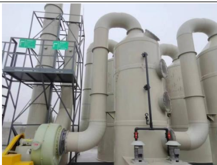
废气处理设施及排气筒
