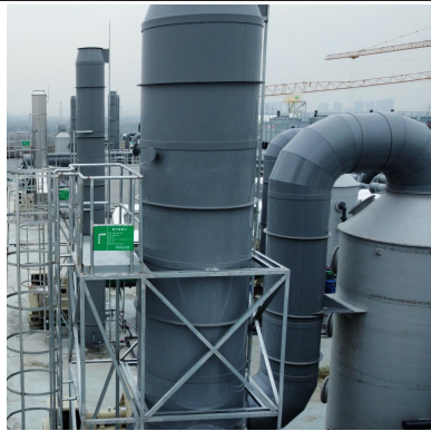
废气处理设施及排气筒
