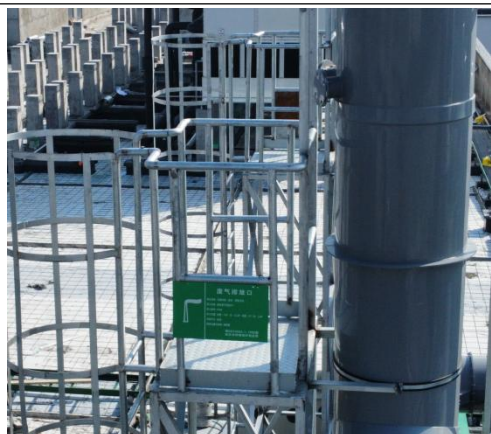
废气处理设施及排气筒
