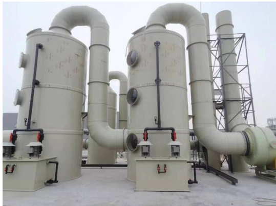
废气处理设施及排气筒
