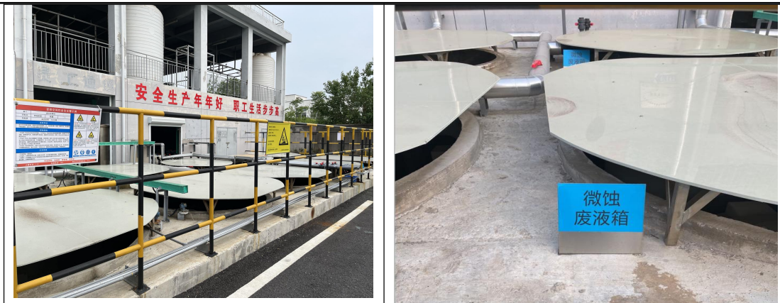
危险废物贮存设施-废液罐区
