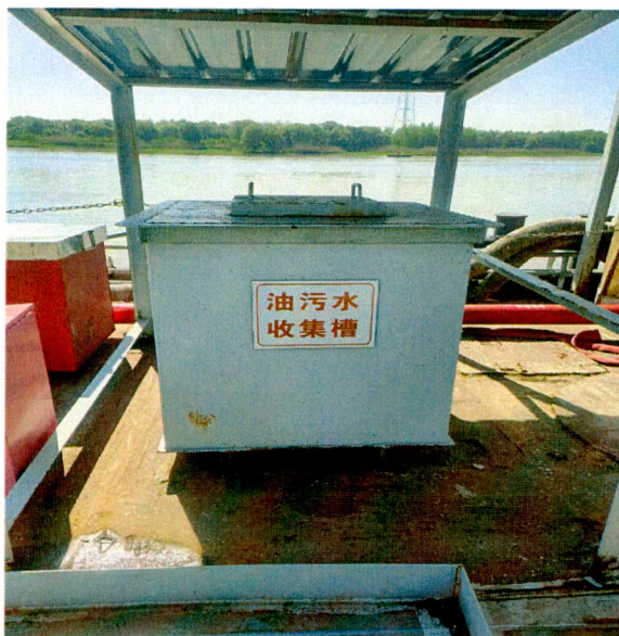
码头油污水收集槽
