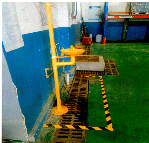
危废库内废液导流槽及收集池
